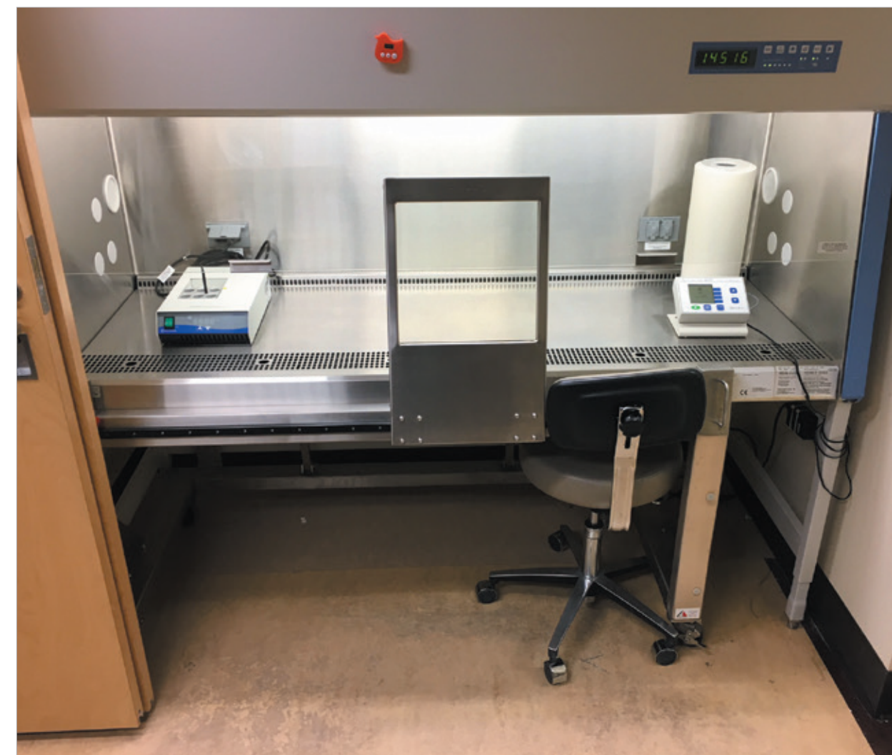
Figure 2 : Hotte à flot laminaire blindée servant aux synthèses stériles de radio-peptides à l'Hôtel-Dieu de Québec.
